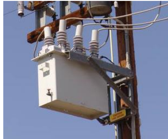
(d) Southern California Edison Recloser
